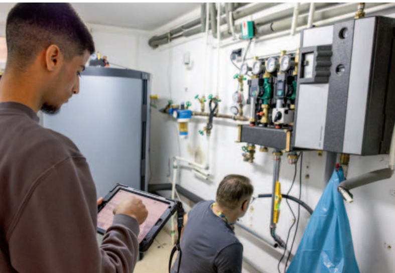
Bei Aquatherm läuft ein Großteil der administrativen Aufgaben vollständig digital – auch auf der Baustelle. (Quelle: Aquatherm, Simplias)
