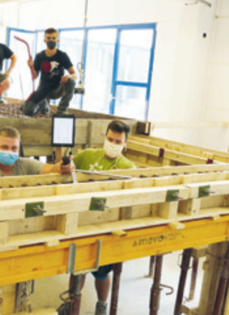
Jeweils eine Gruppe von Azubis bildete eine „Baustellenkolonne“. Die Tablets mit der 123erfasst App haben die angehenden Maurer am Ende des Kurses schon in die Riege ihrer Werkzeuge aufgenommen. Foto: HWK Frankfurt-Rhein-Main
